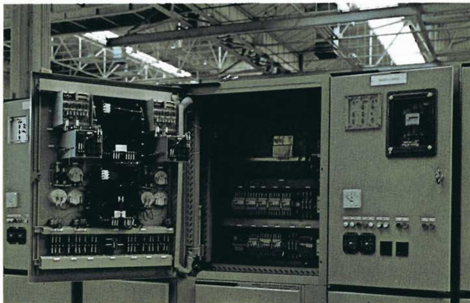
Dette utstyr benyttes til å omforme høy-volts spenning som leveres av kraft-selskapene, til middels høye og lave spenninger.
