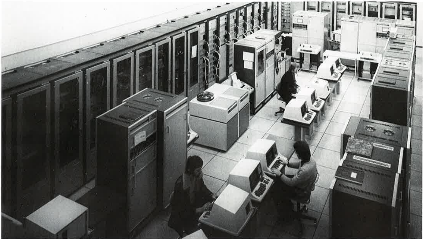
Datamaskinrommet for SPS installasjonen. Ca. 36 NORD-10 datamaskiner av forskjellige årganger er nå koplet til kontrollnettverket.
